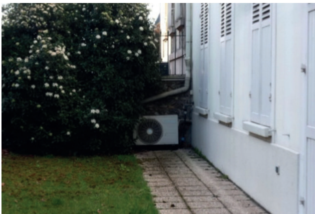
Installation discrète pour une pompe à chaleur air/air sur l'arrière d'une façade, sur cour.
