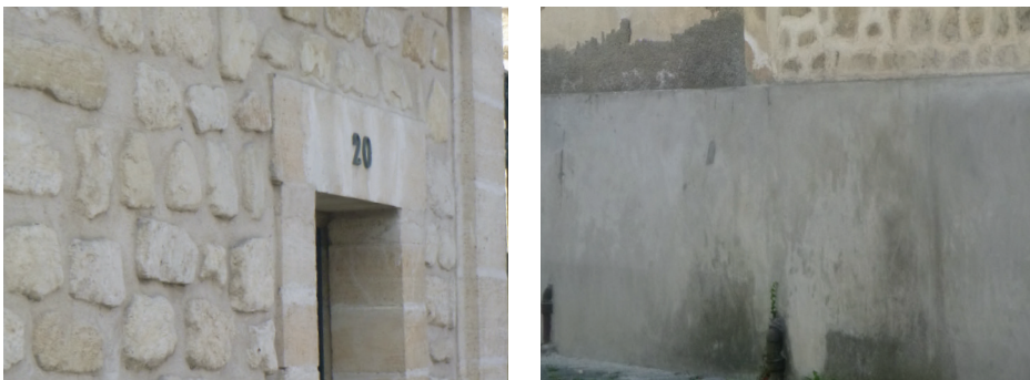
Altérations fréquentes : piochage des enduits, mise en œuvre d'enduits ciments
