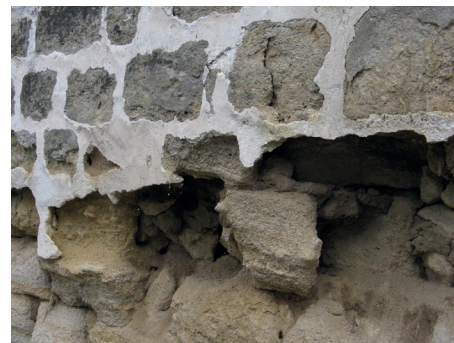
Altérations fréquentes : rejointoiement au ciment
