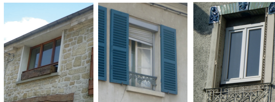
Altérations fréquentes : modification des proportions de la baie, adjonction de volets roulants, menuiseries PVC de taille non adaptée à la baie
